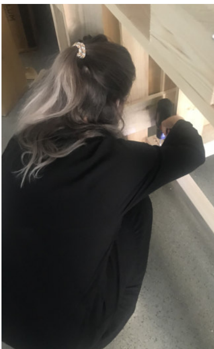
Aufbau der selbst entworfenen Theke aus Paletten für das Beratungscafé im Job-lokal
